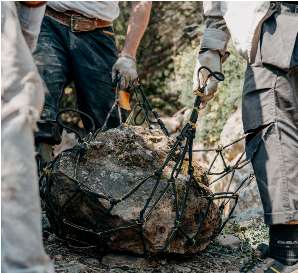
Στιγμιότυπο από τις εργασίες κατασκευής των μικροφραγμάτων στη Σίφνο. Φωτ. Αρης Γιαννούκος
