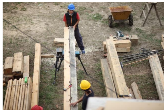
Εικ.26: Κατασκευή κυρίων δοκαριών μικρού παταριού (Ι.Αθανασιάδης) Εικ.27: Αφαίρεση τειγίδων από μικρή στέγη (Ι.Αθανασιάδης) Απέναντι: Τοποθέτηση κυρίων δοκαριών παταριού (Ι.Αθανασιάδης)
