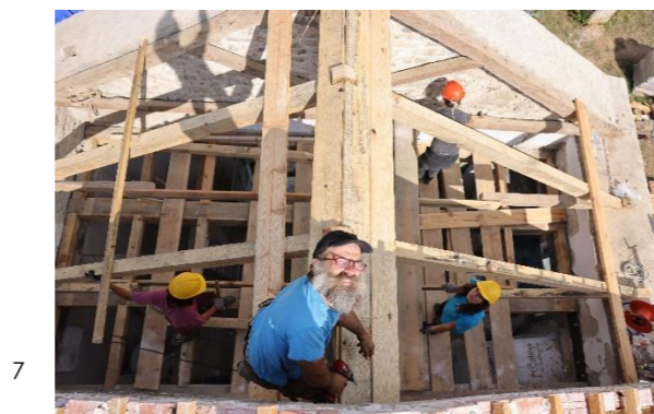
Εικ.3: Πέτσωμα στέγης. Τοποθέτηση των σανιδιών σε κατάλληλες στοίβες στην εκάστοτε πλευρά (Β.Χήτα) Εικ.4: Ανέβασμα σανιδιών στην στέγη (Β.Χήτα) Εικ.5: Ανέβασμα σανιδιών στην στέγη (Ι. Αθανασιάδης) Εικ.6: Ολοκλήρωση πετσώματος (Ι. Αθανασιάδης) Εικ.7: Σκαλώκομα στα σανίδια πάνω από το ζευκτό (Ι.Αθανασιάδης) Απέναντι: Τοποθέτηση σανιδιών (Β.Χήτα)
