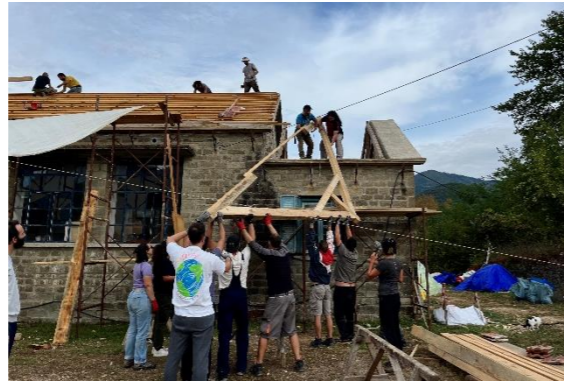
Εικ.37: Ανέβασμα ανακατασκευασμένου ζευκτού στην μικρή στέγη (Β.Χήτα) Εικ.38: Προσωρινό στερέωμα ανακατασκευασμένου ζευκτού (Β.Χήτα) Εικ.39: Τελική τοποθέτηση και βιδώμα ζευκτών μικρής στέγης (Ι.Αθανασιάδης) Απέναντι: Τελική τοποθέτηση και βιδώμα ζευκτών μικρής στέγης (Ι.Αθανασιάδης)
