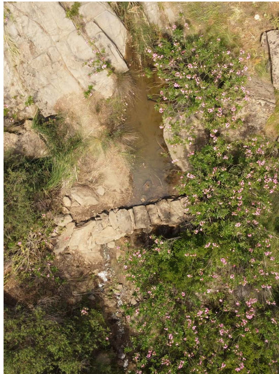
Ένα από τα μικροφράγματα που κατασκευάστηκαν στον Καβουροπόταμο της Πάρου. Φωτ. Γρηγόρης Κουτρόπουλος
